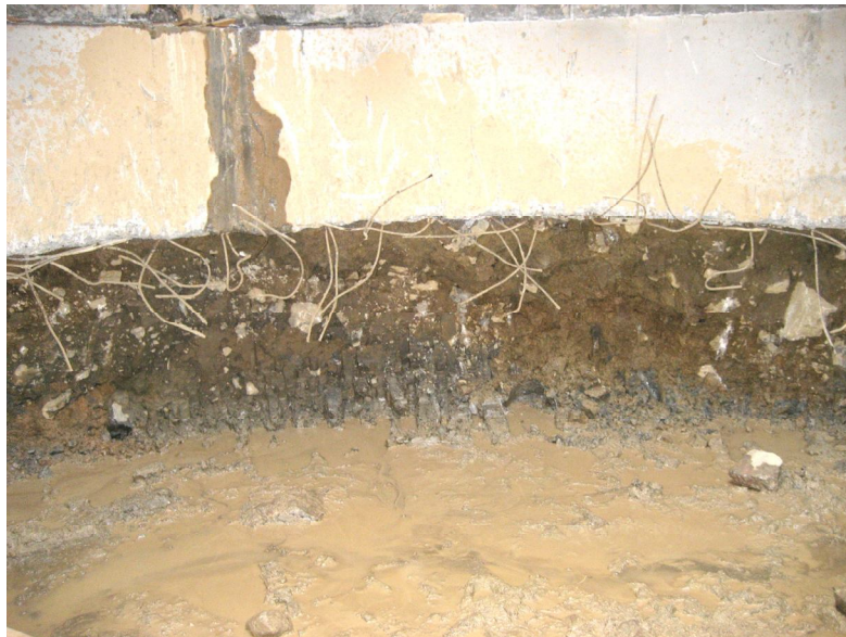
Slika 4. Pogled na porušno drsino pri izkopu za vodnjak 2 na 14 obroču.
